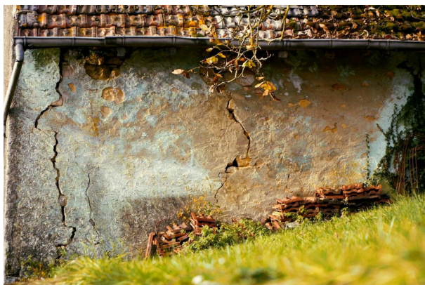
Photo 2, Fissure oblique en angle de baie, façade sud
