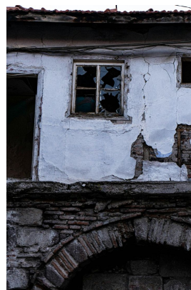
Photo 3, Décollements d'enduit en pied de mur
